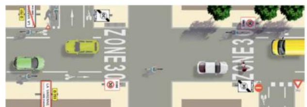
Signalisation d'entrée de zone 30 complétée par marquage
